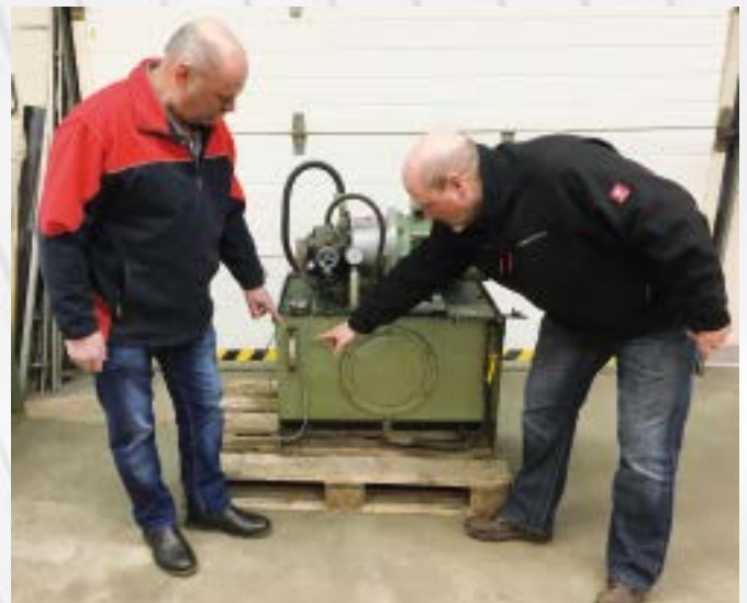
» Wilhelm Brunder (Leiter Maschinenbau, Mr. Wash, links) mit Frank Schulten (HANSA-FLEX). » Wilhelm Brunder (Engineering Department Manager at Mr. Wash, left) and Frank Schulten (HANSA-FLEX).
