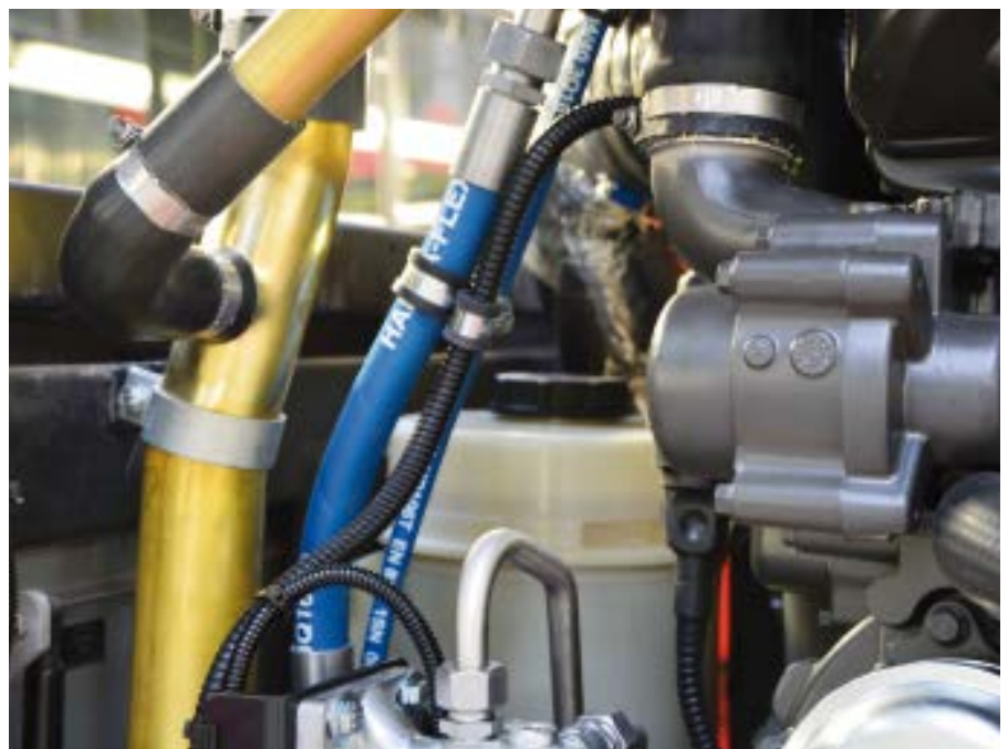
» Aufbau des Motorraums eines Busses von Solaris.
