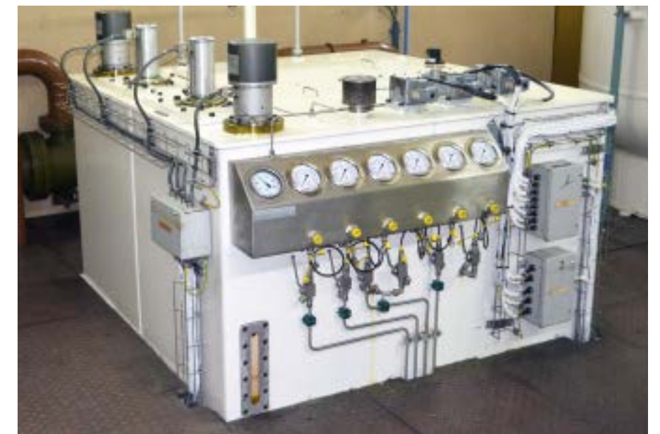
» Der Hydraulikkreislauf wird am Crestuma-Damm rund um die Uhr überwacht. Sowohl Ölstand als auch Druck und Temperatur werden von Sensoren erfasst.
