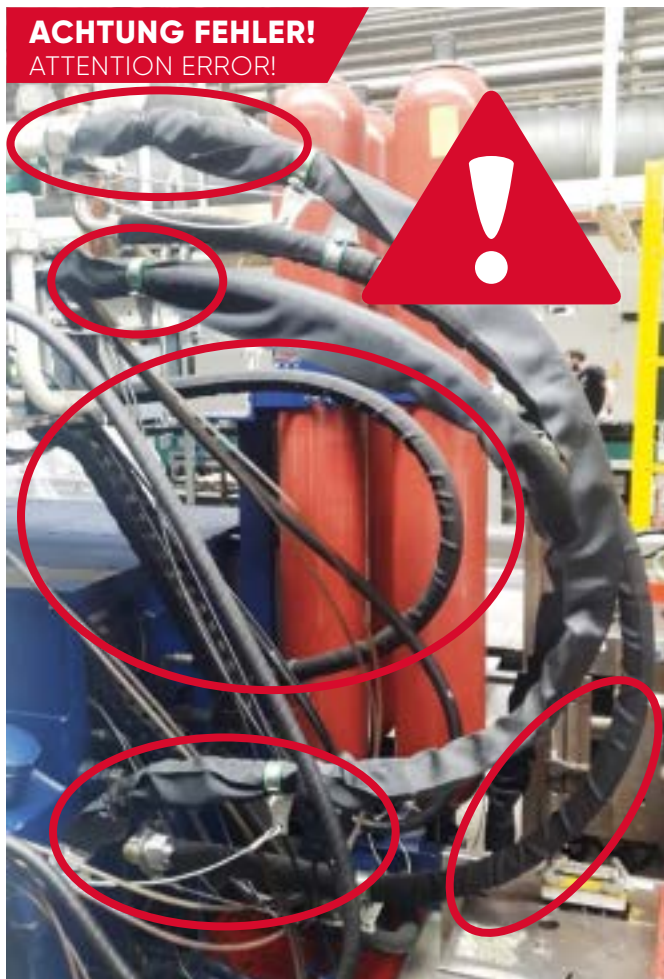
Fangsicberung nicht fachgerecht montiert, Schutzschlauch nicht ausreichend bemessen und angebracht – keine Gewährleistung des sicheren Betriebes.
