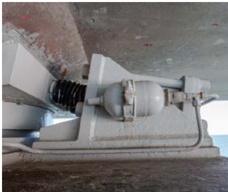
Die feuchte Umgebung führte nach über 20 Jahren vermehrt zu Korrosion, wodurch eine Generalüberholung der Dämpfer erforderlich wurde.
